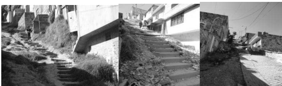
Figura 6. Estado de las vías peatonales en Bolonia (Fuente: Autora)
