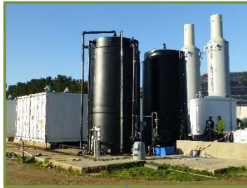
TANQUES AGUA BRUTA
