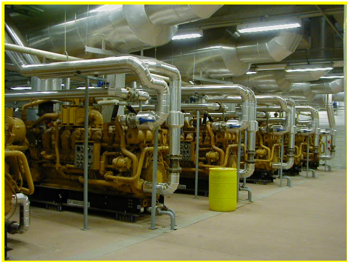
Generador de 480 Volts
