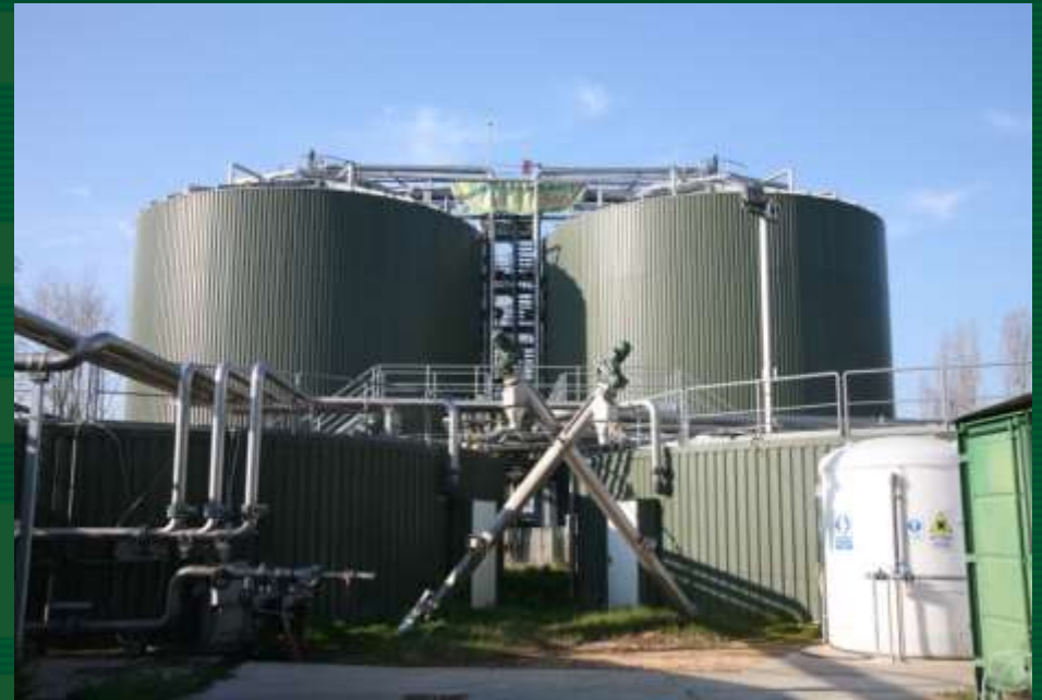
Digestores para Procesar el líquido
